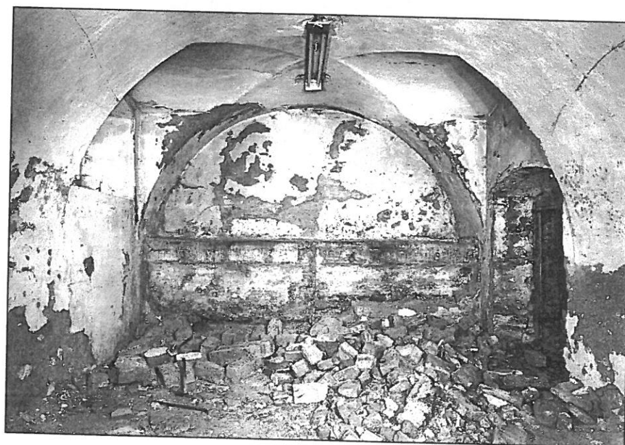
Objekt bez údržby – poškozená krytina, absence odvodnění střech, vztlínající vlhkost ..... (foto Ladislav Bezděk)
