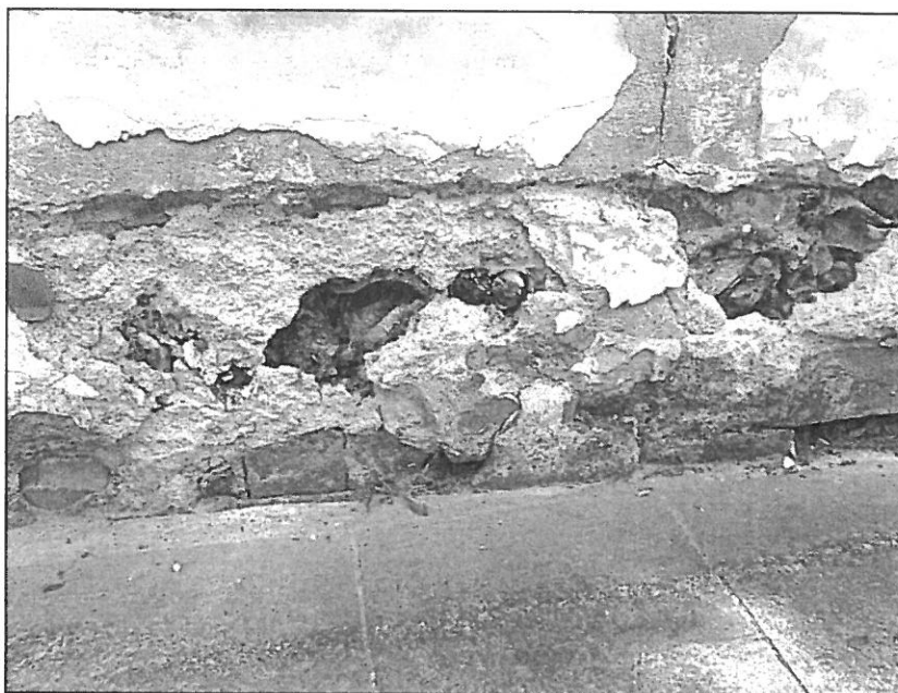
Asfaltový nátěr přímo na zdivu ... omítka poškozená vzlínající vlhkostí (foto autor)
